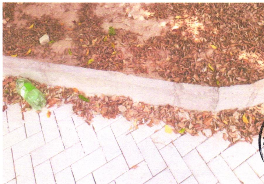
FOTO 04 - ASSENTAMENTO DE GUIA (MEIO-FIO) EM TRECHO RETO, CONFECCIONADA EM CONCRETO PRÉFABRICADO, DIMENSÕES 100X15X13X20 CM (COMPRIMENTO X BASE INFERIOR X BASE SUPERIOR X ALTURA), PARA URBANIZAÇÃO INTERNA DE EMPREENDIMENTOS.
